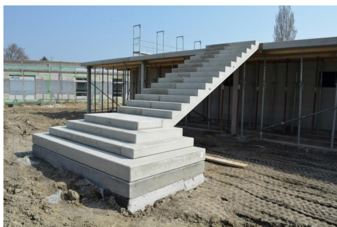
mit Sonderanfertigung für den Treppenzugang
